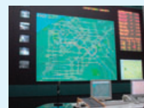
道路交通管制システム
